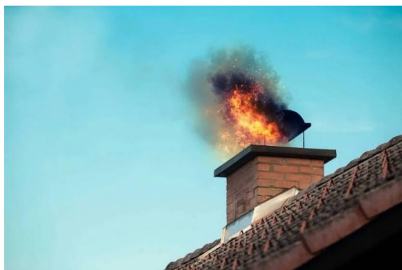
Сгорание сажи в дымоходе при использовании «Полена-трубочиста».
